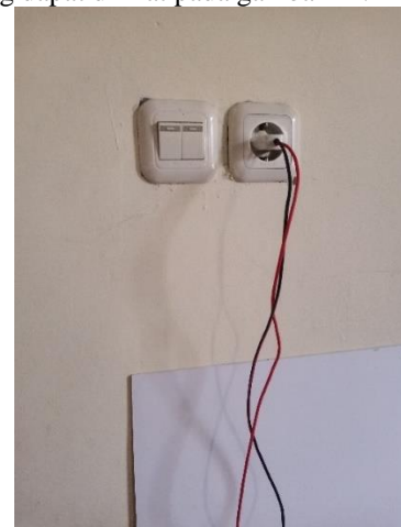
Gambar 11 Alat Terpasang Pada Listrik
